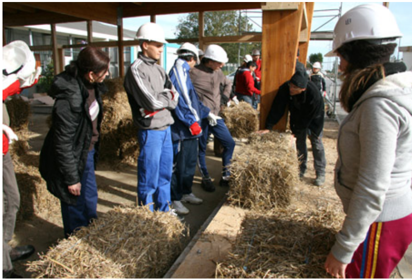
Chantier participatif du local des jeunes Le chantier participatif s'est déroulé du 24 octobre au 2 novembre 2011.
